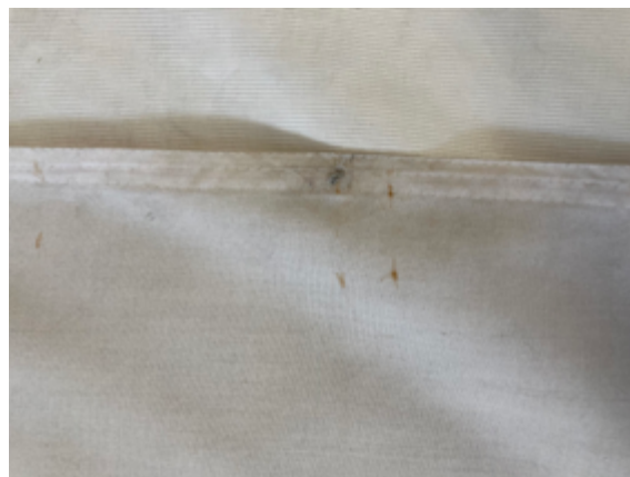
Fig. 3 | Perforación y mancha localizadas sin identificar (Imagen propia).
